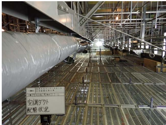
天井裏空調ダクト配管
